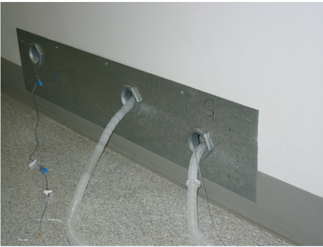
Figura 8.3 Un entarimado reforzado en la sala de resonancia magnética proporciona aperturas para las líneas intravenosas y las mangueras de circuito.
